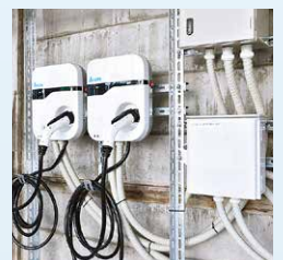
2023年より電気自動車を2台導入。社屋横にはEV充電機が設置されている
