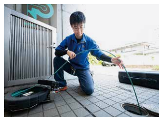
給排水管の劣化診断から清掃、メンテナンスまでワンストップで手掛ける
